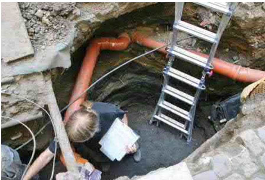
Běžný obrázek ve výkopech pro inženýrské sítě – souběžně vytvářená archeologická dokumentace. Sled vrstev se s geodetickou přesností všech tří rozměrů zakresluje na milimetrový papír v měřítku 1 : 20, poté se každá vrstva slovně charakterizuje a odeberou se z ní vzorky. Foto: Jarmila Čiháková, 2012.
