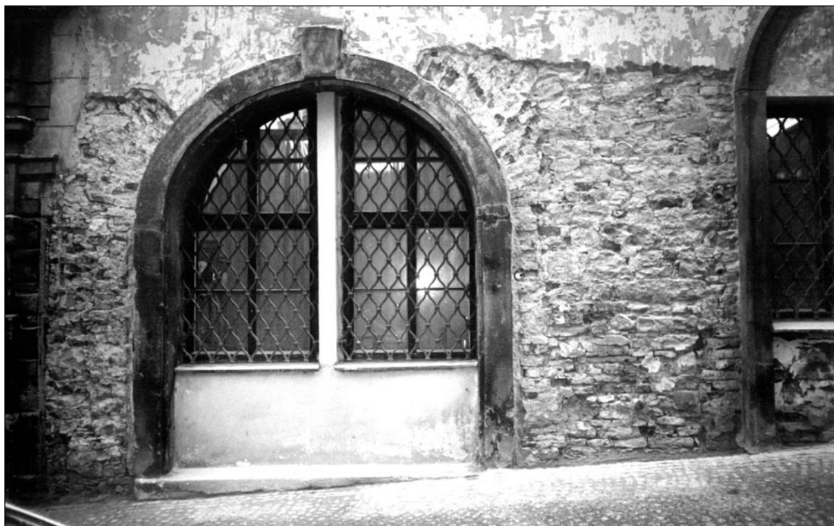
OBR. 5: POHLED NA PRŮČELNÍ FASÁDU ČP.249/III V MÍSTĚ STYKU DVOU TRAKTŮ. FOTO M. KOVÁŘ.
