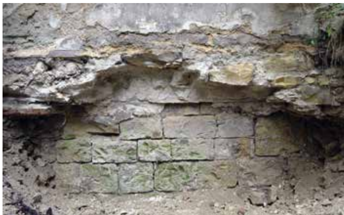
Obr. 9. Praha 1-Staré Město, Bartolomějská čp. 309. Úsek interiérového líce polozahroubeného suterénu ve střední části jižní obvodové zdi románského domu v místě zasypané statické sondy (sonda S2). Dno sondy se nalézalo v hloubce 1,2 m pod dnešním terénem na niveletě 190,1 (foto M. Semerád, 2012).
