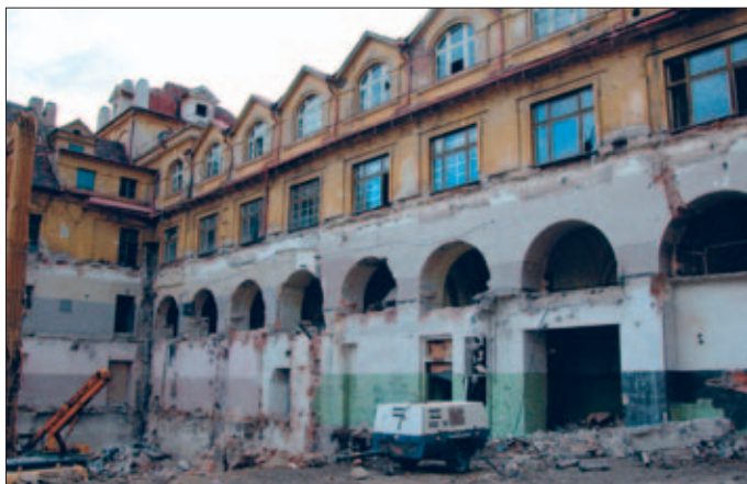
Obr. 5. Jižní křídlo dominikánského kláštera sv. Maří Magdalény s ambitem před zahájením rekonstrukce. Pohled z rajského dvora (od severozápadu). Stav v r. 2003 po odstranění přístavby z 19. a 20. století (foto J. Hlavatý, 2003).
